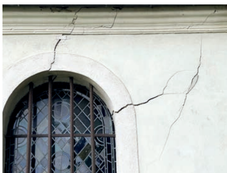
L'une des nombreuses fissures extérieures
